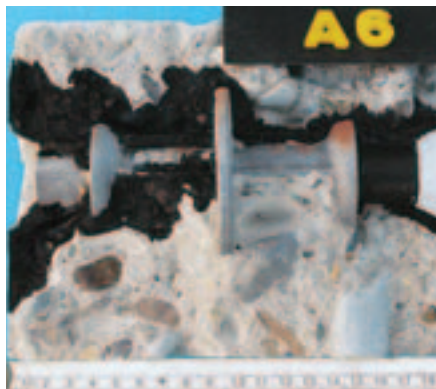
ja vesitiiveysvälikkeiden ympärillä aiheuttaneet vuodon.
